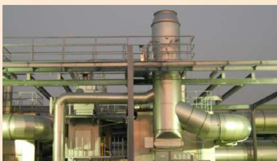
揮發性有機物廢氣處理設施
