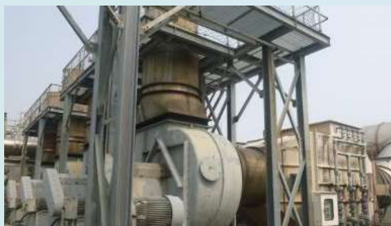
酸、鹼性廢氣處理設施
