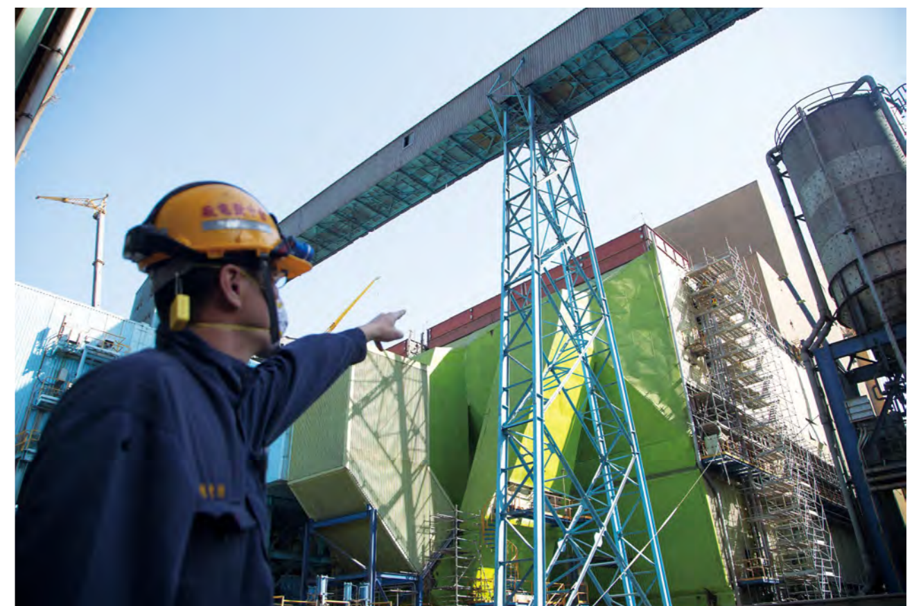
台中發電廠封閉式生煤輸送皮帶可降低煤塵逸散
