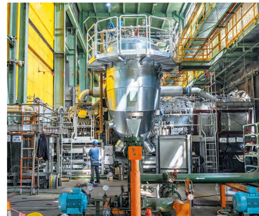
興達電廠燃氣複循環機組熱元件逐步升級
